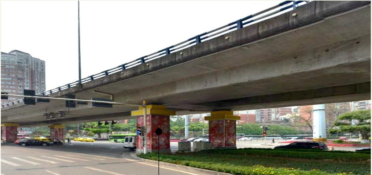
● 桥墩加挂灯箱
