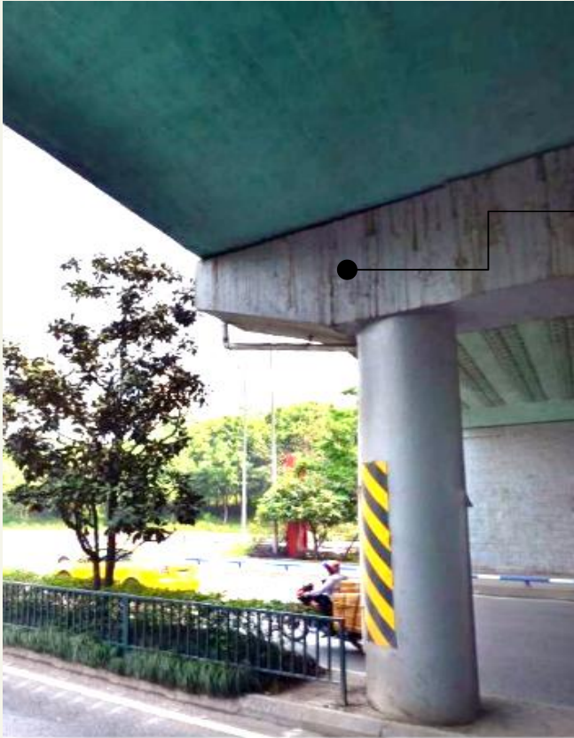
● 桥墩盖梁表面存在水渍、污垢
